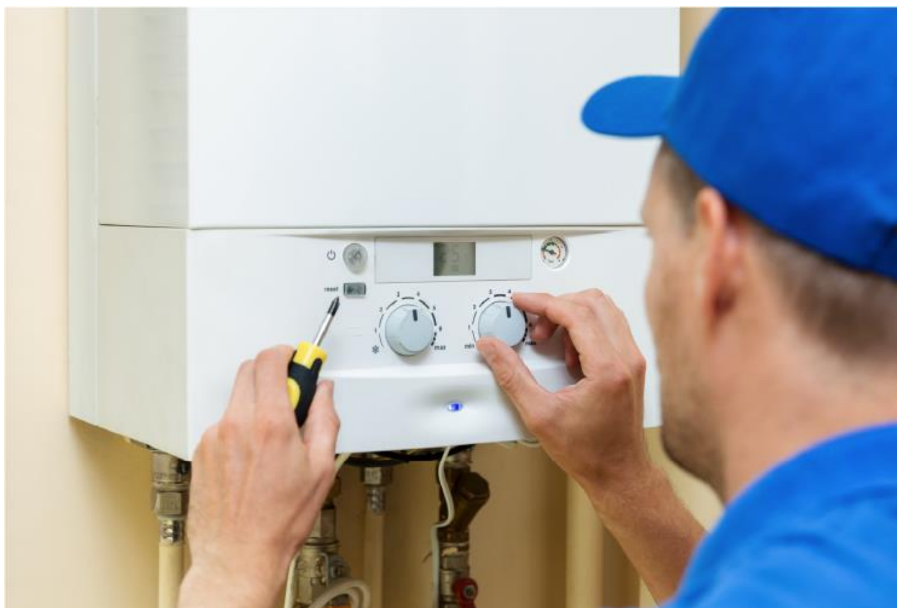
Intervento del tecnico per il controllo della caldaia
