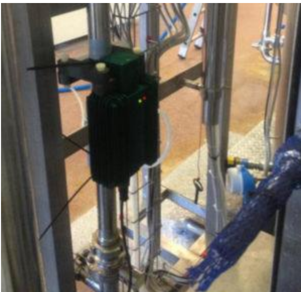
AquaRing® installato nella tubazione dell'acqua
