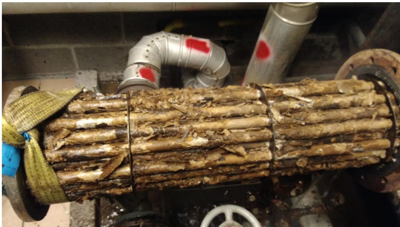
Fascio tubiero dello scambiatore di calore completamente incrostato di calcare senza l'azione di AquaRing®
